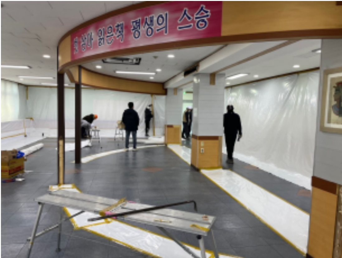
<2021 년 겨울방학 **고등학교 사례: 바닥>벽>바닥>벽 이런순서로 2 겹보양을 해야하나, 그냥 2 장을 통으로 벽면>바닥으로 보양함.>
