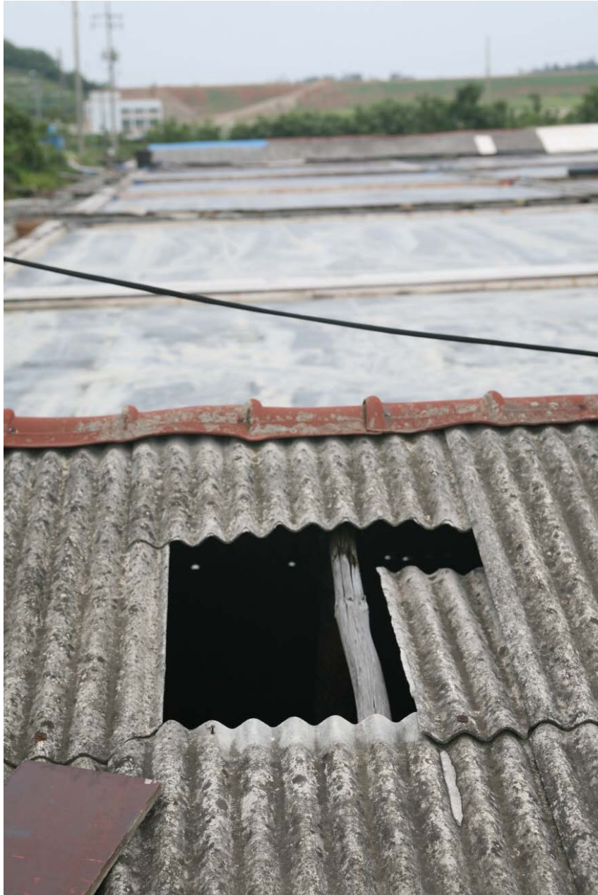
<사진, 전남신안의 한 염전, 낡은 석면슬레이트로 덮인 해주창고지붕 너머로 염전이 보인다>
