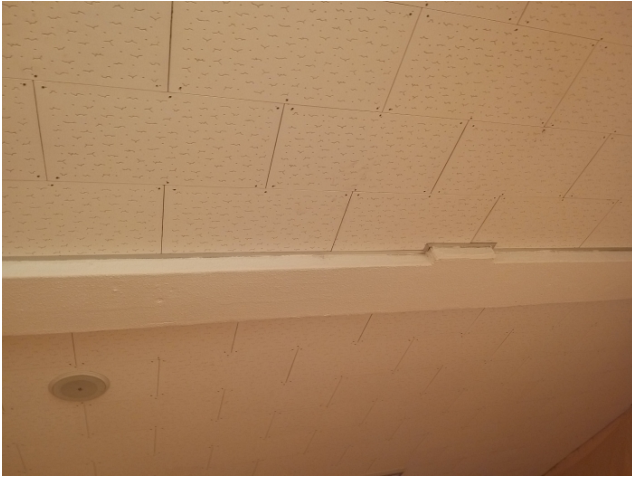
1/17 안강전자고등학교 비닐보양 천장의 콘크리트 보가 비닐보양 안 되어 있음
