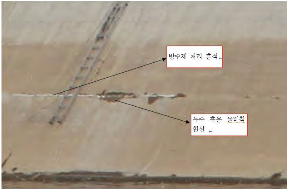
▲ 가로방향으로 물이 새 흔적 위로 흰색 방수처리 흔적. 여전히 물이 새는 흔적이 보임. (1월 12일 )
