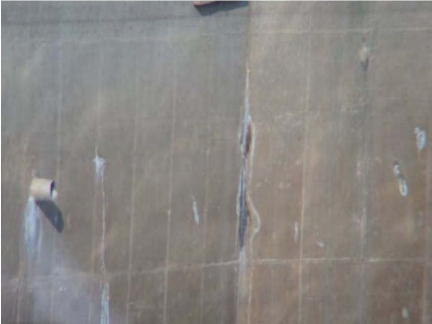
▲ 승촌보 소수력발전소 쪽 용벽(우안) 벽체에 방수제와 에폭시수지 발포 흔적.(1월 5일)
